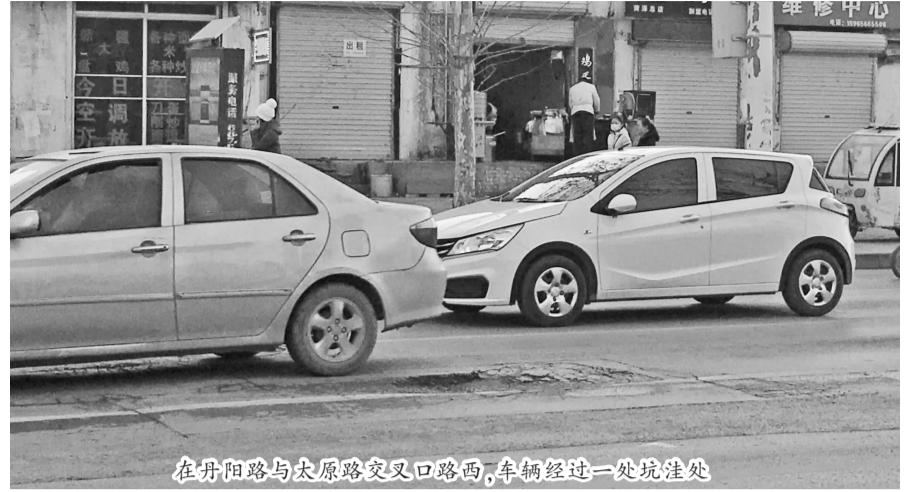
在丹阳路与太原路交叉口路西，车辆经过一处坑洼处
